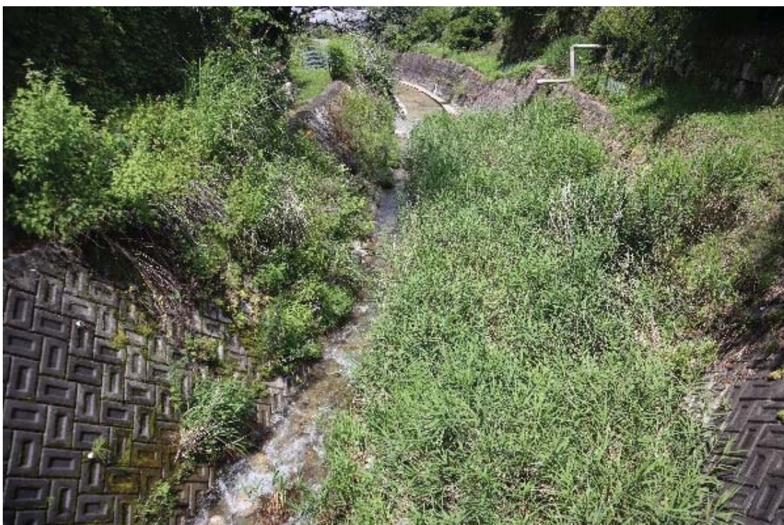
②岩村町朝日町地内から大通寺地内（進学橋から下流） 浚渫
